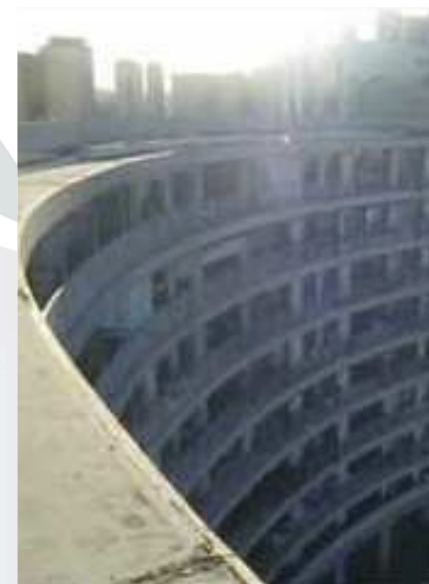
Vue sur façade avant travaux de la copropriété Fontaine d'Aligre. © Enera Conseil
