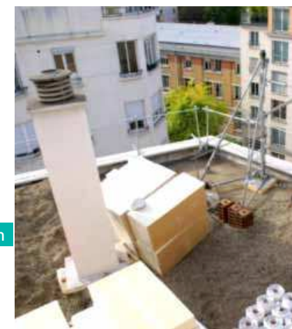
Toiture de l'immeuble Dagorno en travaux, panneaux isolants. © Copropriétaire du 59 – 61 rue Picpus / 1 rue Dagorno 75012 PARIS
